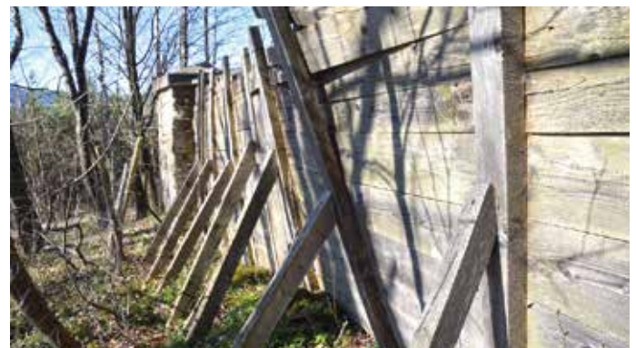
Abstützung der schwer beschädigten Einfriedungsmauer des Kriegerfriedhofes Nr. 80 Sękowa im April 2021
