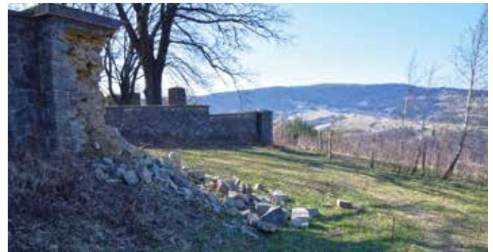
Schwere Schäden an der Einfriedungsmauer des Kriegerfriedhofes Nr. 80 Sękowa im April 2021
